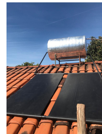
Figura 21: Sistema ASBC instalado. (Fonte: Acervo Contraponto)
