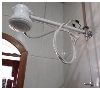
Figura 04: Misturador de água quente acoplado ao chuveiro elétrico. (Fonte: Acervo Contraponto)
