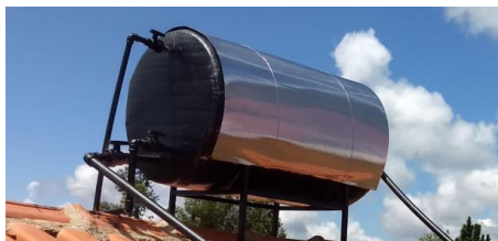
Figura 03: Reservatório revestido com manta térmica (Fonte: Acervo Contraponto)
